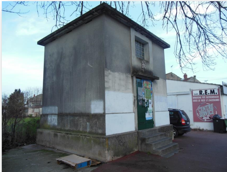
Figure 38 : Transformateur « hors sol »
