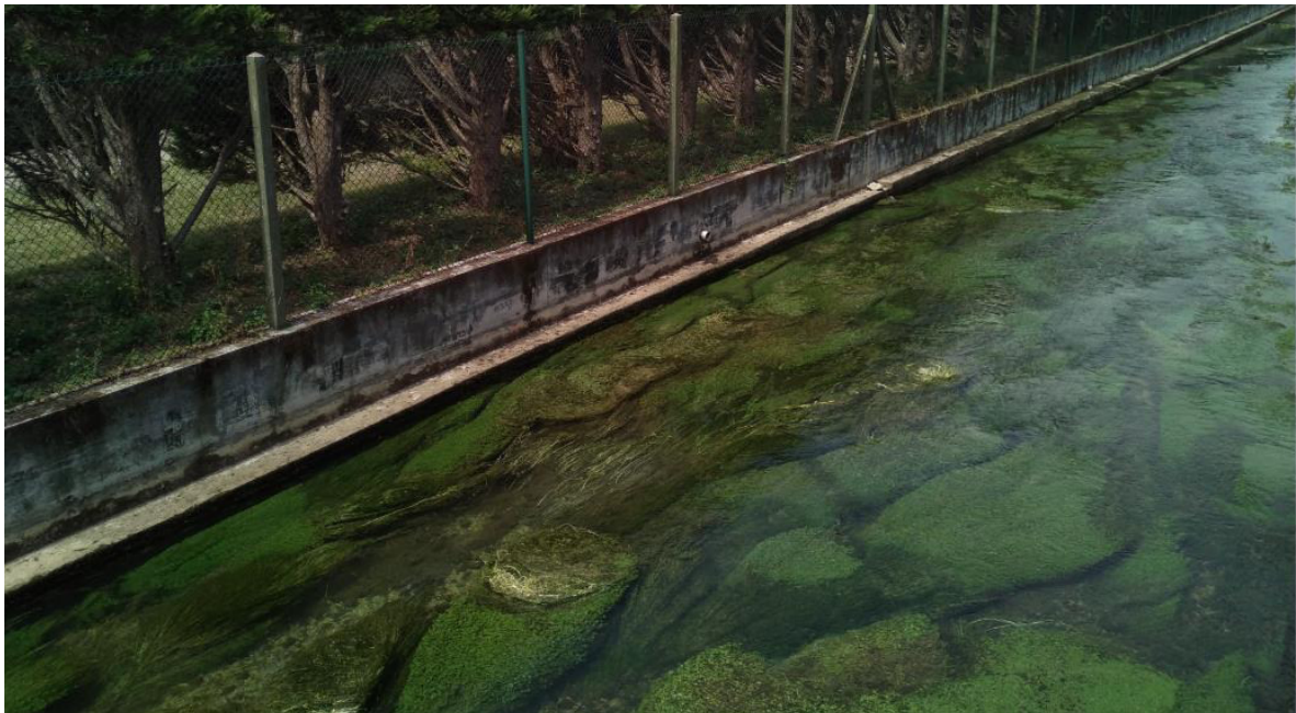
Figure 8 : Photographie illustrant l'impact des herbiers aquatiques de la Maillerie sur les écoulements. Toute la section est encombrée (source Eaucéa).
