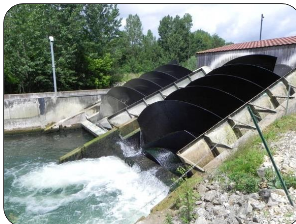
Figure 127 : Double vis d'Archimède installées au Moulin de la Chapelle (ROE52887)
