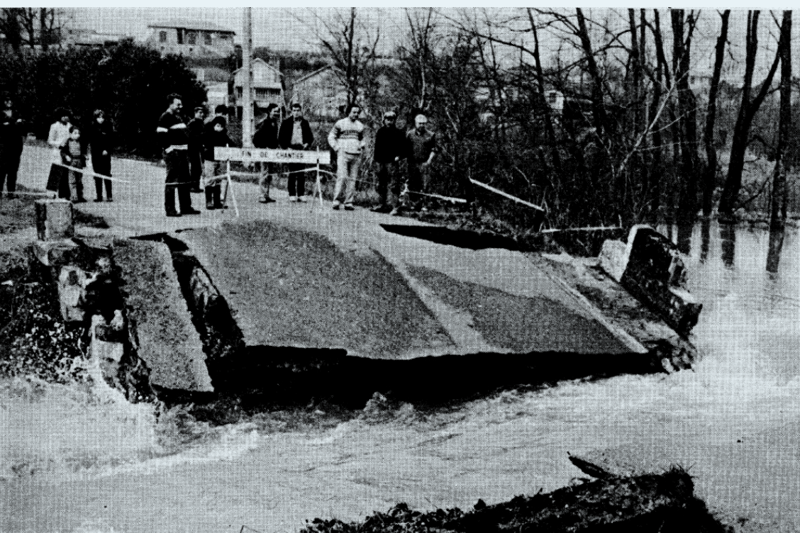
Effondrement du pont de la départementale à Sireuil - 1982
